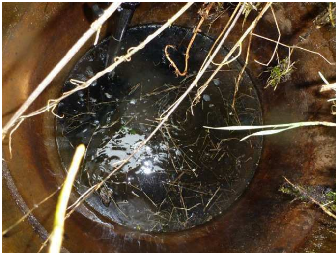
Figur 13: Brønd 3. Brønden havde et knækket dæksel.
