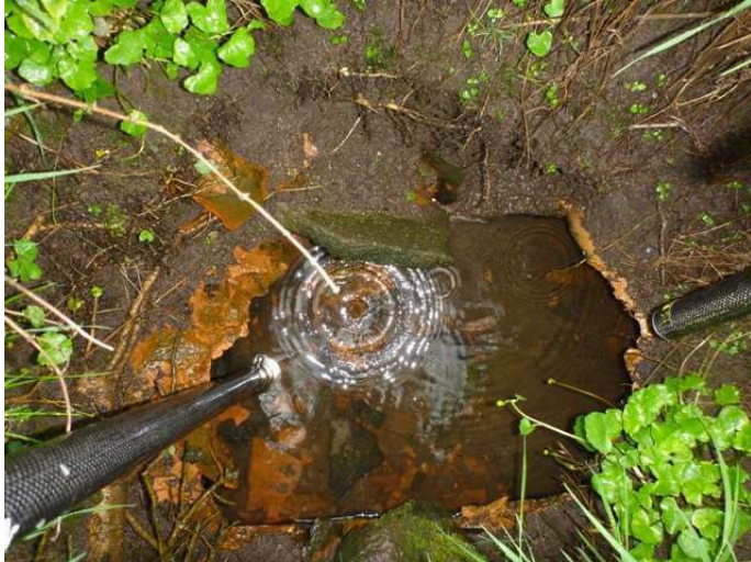
Figur 6: Ødelagt drænrør. Fra. St. 300 – 500 m var der adskillige jordfaldshuller.
