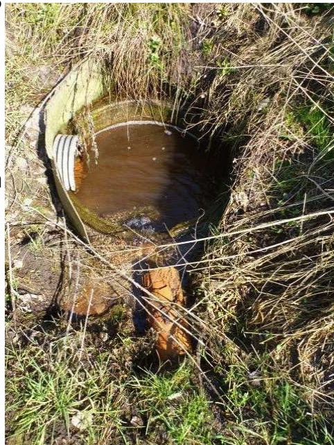
Figur 13: Brønd 1 i et jordfaldshul.
