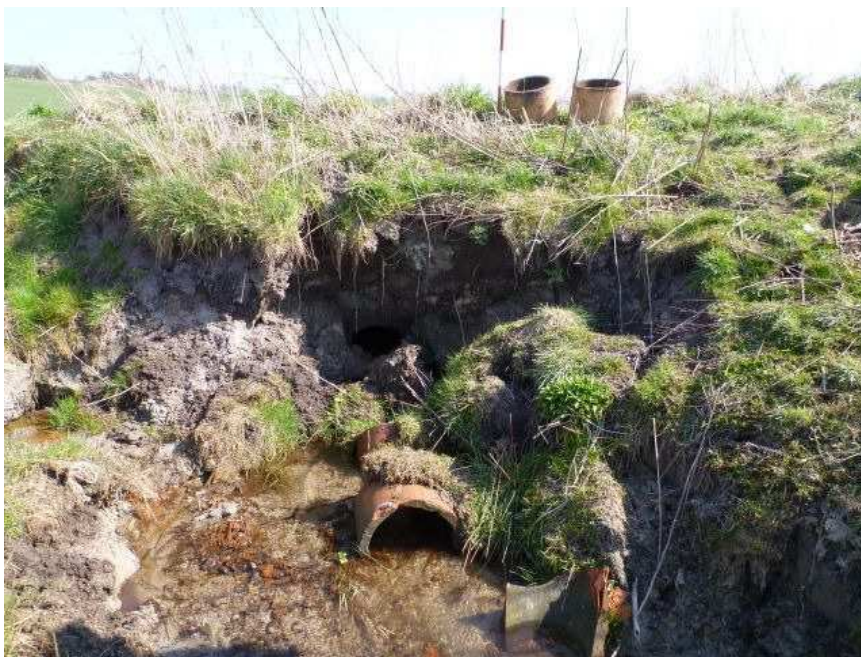
Figur 3: Udskredet jord ved rørdløb i st. 950 m.
