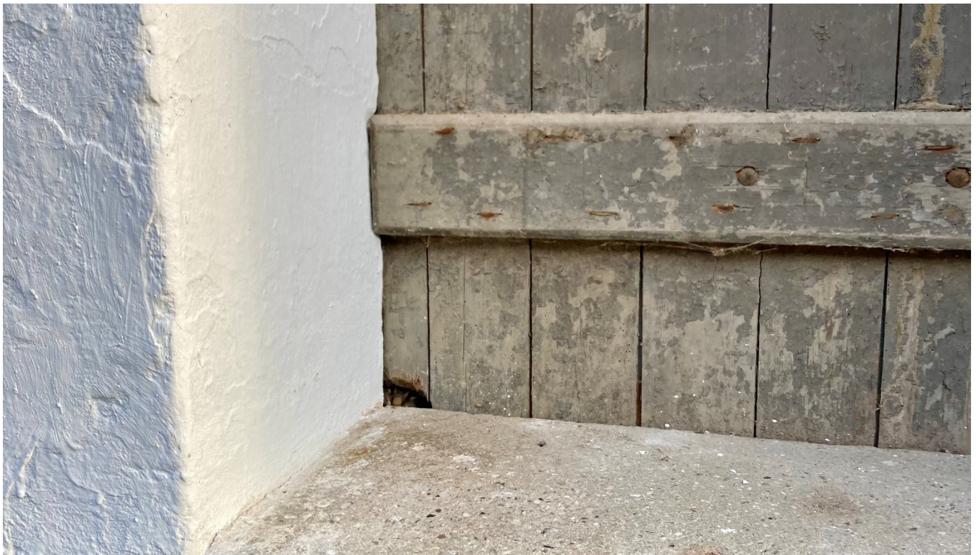
Figur 11 - Rottehul i en stalddør ind til et hønsehold.
